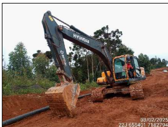
FIGURA 24: ATIVIDADES PARALISADAS DEVIDO ÀS CHUVAS.
