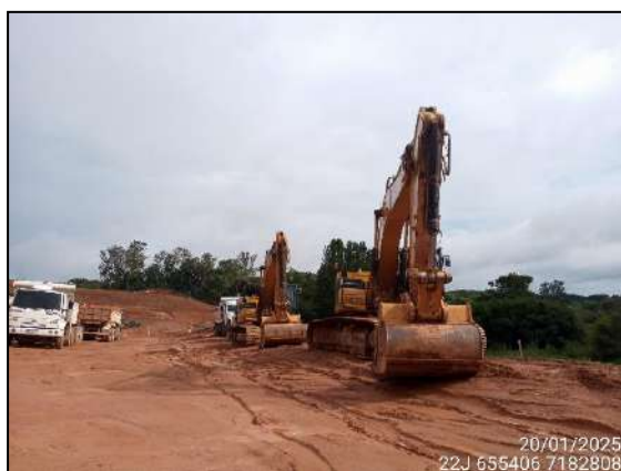
FIGURA 1: ATIVIDADES PARADAS DEVIDO À CHUVA.
