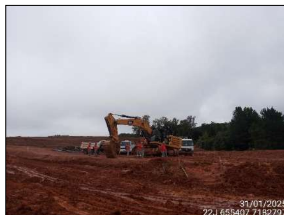
FIGURA 10: ATIVIDADES PARADAS DEVIDO À CHUVA.
