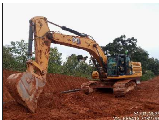
FIGURA 9: ATIVIDADES PARADAS DEVIDO À CHUVA.
