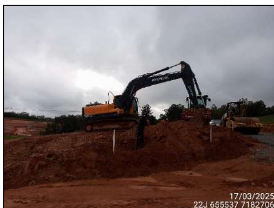
FIGURA 35: ATIVIDADES PARALISADAS DEVIDO ÀS CHUVAS.
