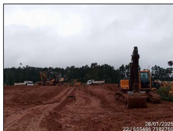
FIGURA 4: ATIVIDADES PARADAS DEVIDO À CHUVA.
