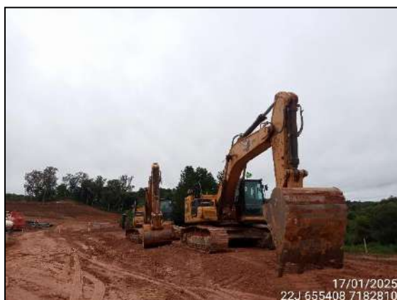
FIGURA 10: ATIVIDADES PARALISADAS DEVIDO ÀS CHUVAS.
