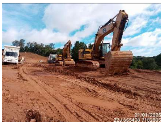
FIGURA 12: ATIVIDADES PARALISADAS DEVIDO ÀS CHUVAS
