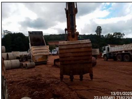
FIGURA 1: ATIVIDADES PARADAS DEVIDO À CHUVA.
