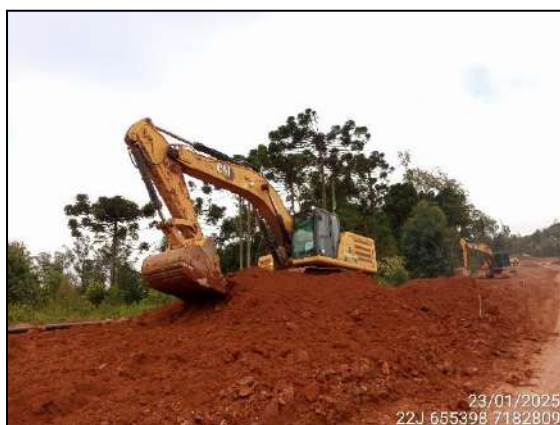
FIGURA 14: ATIVIDADES PARALISADAS DEVIDO ÀS CHUVAS
