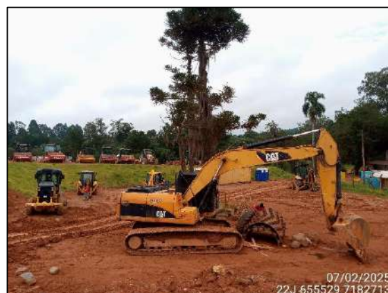
FIGURA 27: ATIVIDADES PARALISADAS DEVIDO ÀS CHUVAS.
