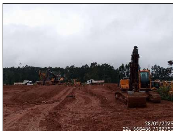
FIGURA 19: ATIVIDADES PARALISADAS DEVIDO ÀS CHUVAS
