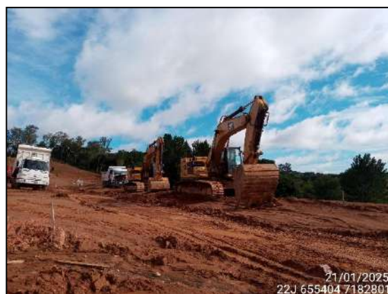
FIGURA 2: ATIVIDADES PARADAS DEVIDO À CHUVA.
