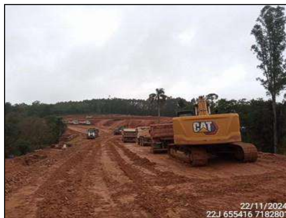
FIGURA 8: ATIVIDADES PARADAS DEVIDO À CHUVA.
