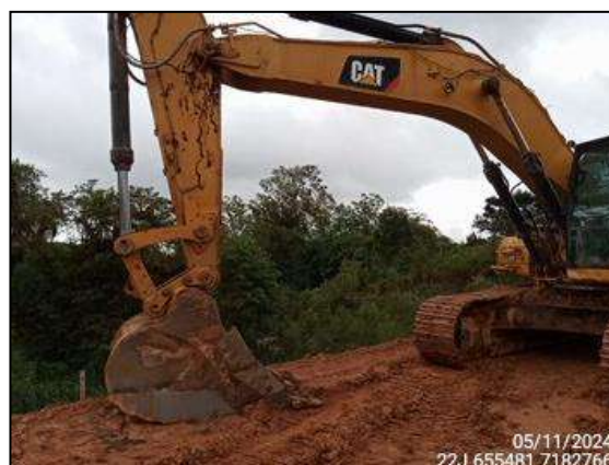
FIGURA 2: ATIVIDADES PARADAS DEVIDO À CHUVA.
