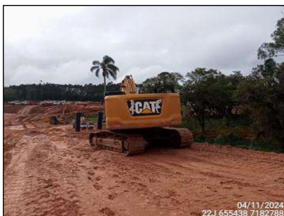
FIGURA 1: ATIVIDADES PARADAS DEVIDO À CHUVA.
