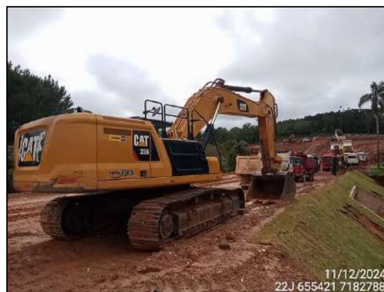
FIGURA 74: ATIVIDADES PARALISADAS DEVIDO ÀS CHUVAS
