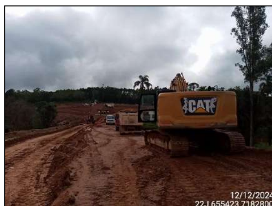
FIGURA 4: ATIVIDADES PARADAS DEVIDO À CHUVA.
