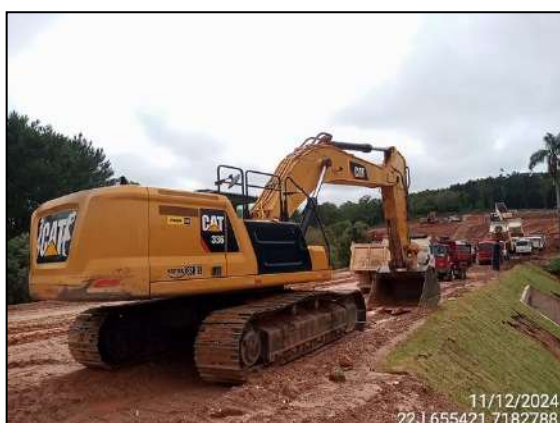
FIGURA 3: ATIVIDADES PARADAS DEVIDO À CHUVA.
