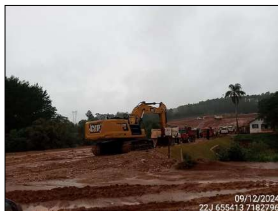
FIGURA 72: ATIVIDADES PARALISADAS DEVIDO ÀS CHUVAS
