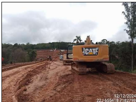
FIGURA 75: ATIVIDADES PARALISADAS DEVIDO ÀS CHUVAS
