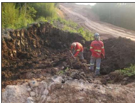
FIGURA 65: VERIFICAÇÃO ATIVA NA ÁREA EM QUE FOI IDENTIFICADO O MATERIAL QUE COMPÕE A OCORRÊNCIA TIMBUTUVA 2.
