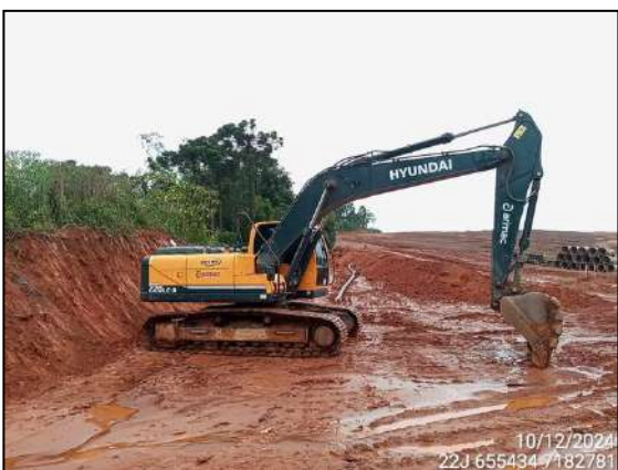
FIGURA 73: ATIVIDADES PARALISADAS DEVIDO ÀS CHUVAS
