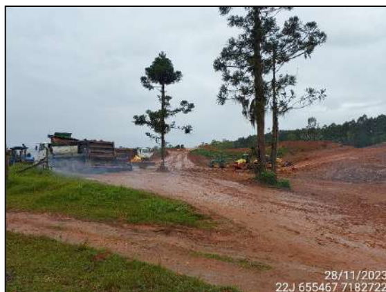
FIGURA 2: OBRA PARALISADA DEVIDO AS CHUVAS NA REGIÃO.
