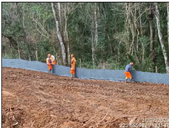
FIGURA 18: CERCAMENTO EM ÁREA DE PRESERVAÇÃO PERMANENTE.
