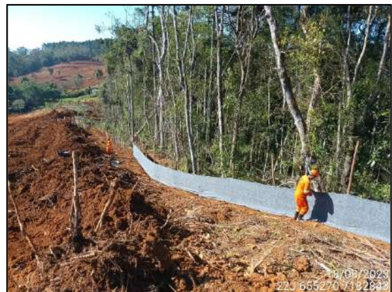
FIGURA 68: CERCAMENTO EM ÁREA DE PRESERVAÇÃO PERMANENTE.
