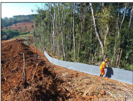
FIGURA 5: CERCAMENTO EM ÁREA DE PRESERVAÇÃO PERMANENTE.
