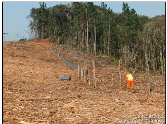
FIGURA 4: CERCAMENTO EM ÁREA DE PRESERVAÇÃO PERMANENTE.
