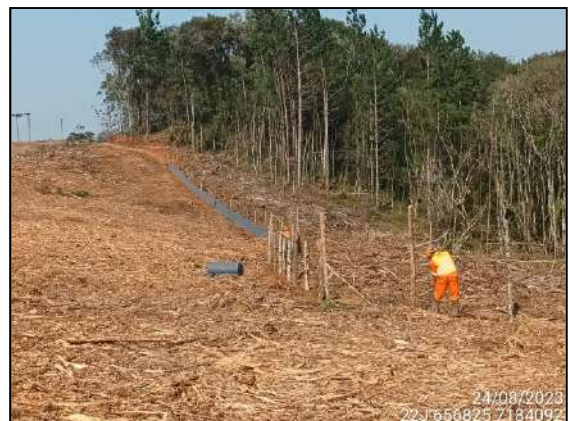
FIGURA 72: CERCAMENTO EM ÁREA DE PRESERVAÇÃO PERMANENTE.
