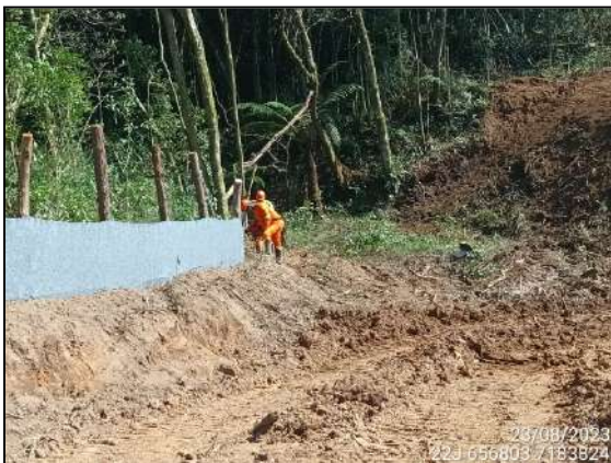
FIGURA 3: CERCAMENTO EM ÁREA DE PRESERVAÇÃO PERMANENTE.
