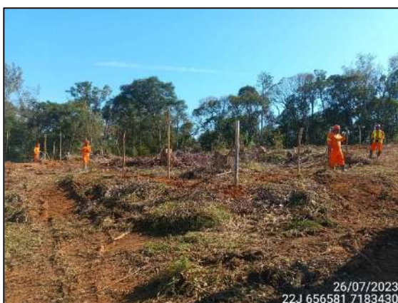
FIGURA 22: CERCAMENTO EM ÁREA DE PRESERVAÇÃO PERMANENTE.
