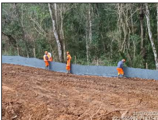
FIGURA 5: CERCAMENTO EM ÁREA DE PRESERVAÇÃO PERMANENTE.
