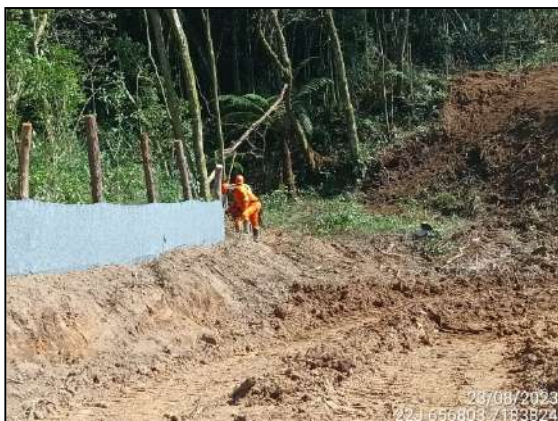
FIGURA 71: CERCAMENTO EM ÁREA DE PRESERVAÇÃO PERMANENTE.
