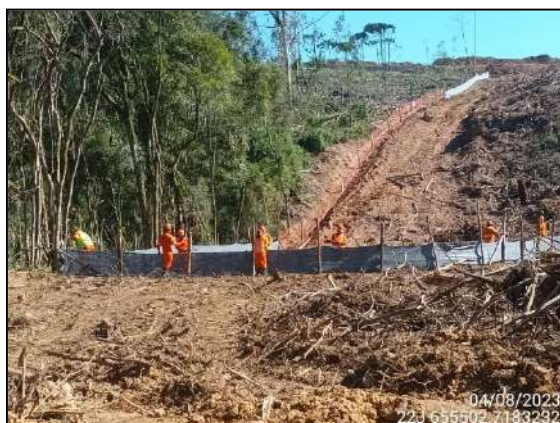
FIGURA 4: CERCAMENTO EM ÁREA DE PRESERVAÇÃO PERMANENTE.
