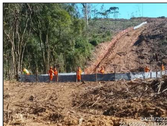
FIGURA 58: CERCAMENTO EM ÁREA DE PRESERVAÇÃO PERMANENTE.
