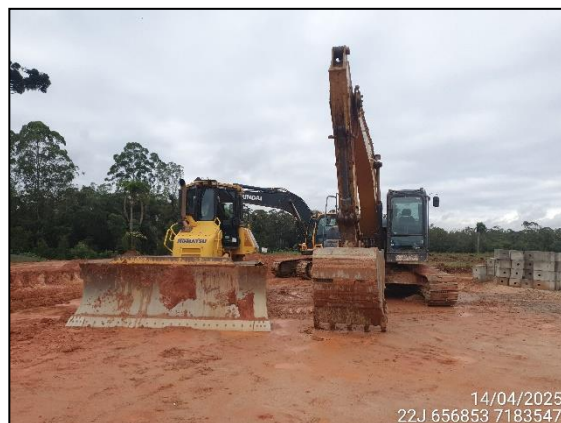
FIGURA 2: ATIVIDADES PARADAS DEVIDO À CHUVA.
