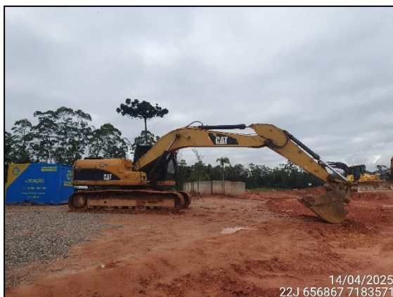
FIGURA 1: ATIVIDADES PARADAS DEVIDO À CHUVA.
