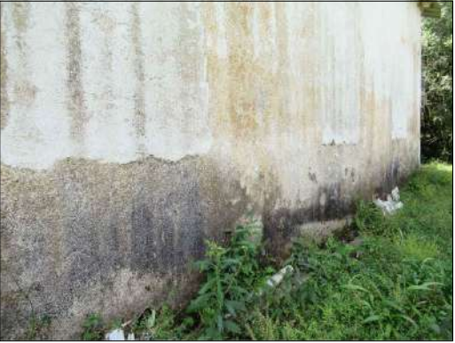
Umidade ascendente na fachada Sudoeste. Acervo próprio, 2021.
