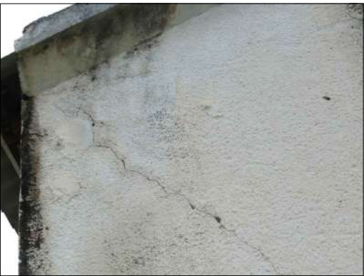
Fissura na fachada Noroeste. Acervo próprio, 2021.
