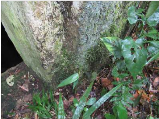
Umidade ascendente Acervo próprio, 2021.
