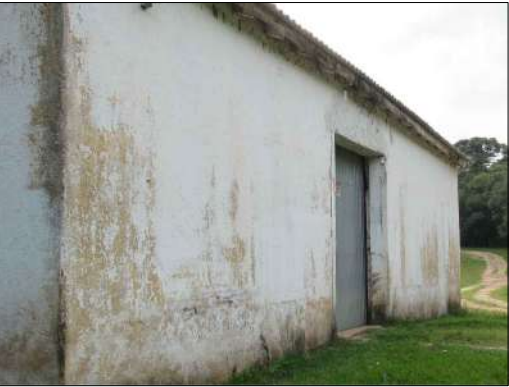
Sujidade na fachada Nordeste. Acervo próprio, 2021.
