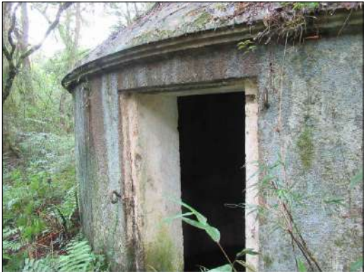
Ausência de elemento (porta) Acervo próprio, 2021.
