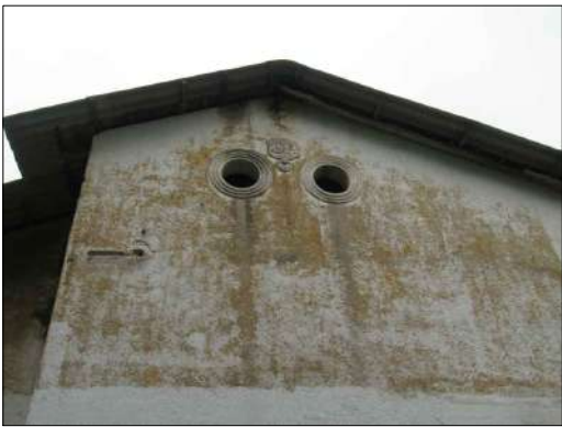
Sujidade na fachada Sudeste. Acervo próprio, 2021.
