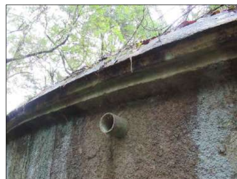
2 Canos nas fachadas Acervo próprio, 2021.
