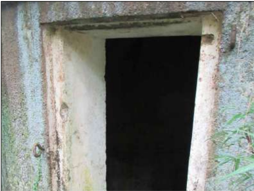
Desprendimento de argamassa e pintura Acervo próprio, 2021.
