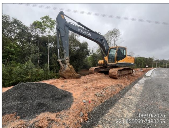
FIGURA 4: ATIVIDADES PARALISADAS DEVIDO AS FORTES CHUVAS NA REGIÃO
