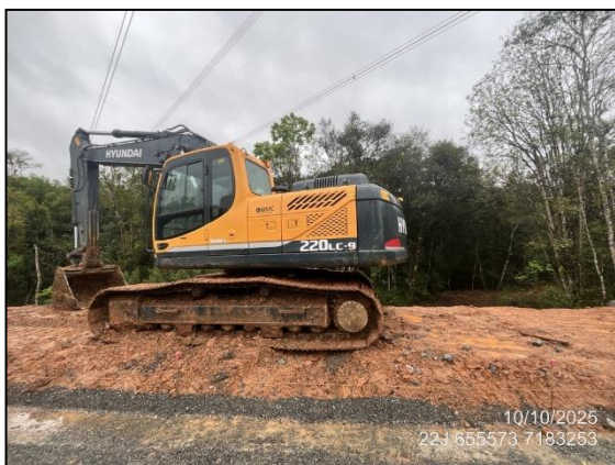
FIGURA 3: ATIVIDADES PARALISADAS DEVIDO AS FORTES CHUVAS NA REGIÃO
