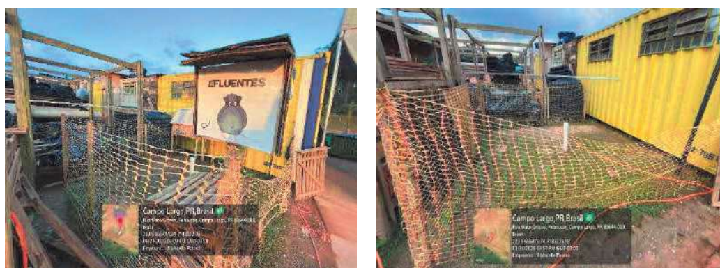
Figura 31 – Tanques impermeáveis para armazenamento do efluente
