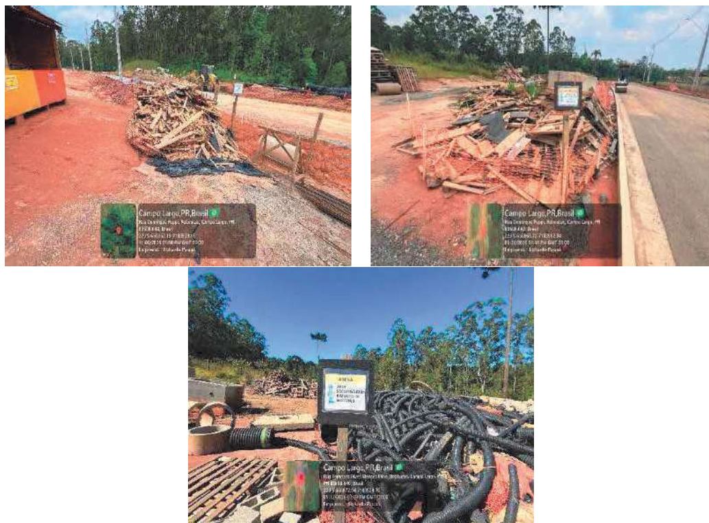
Figura 21 – Locais delimitados e sinalizados armazenam adequadamente resíduos Classe B
