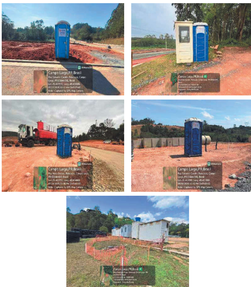
Figura 15 – Banheiros químicos e sanitários containers disponíveis aos colaboradores
