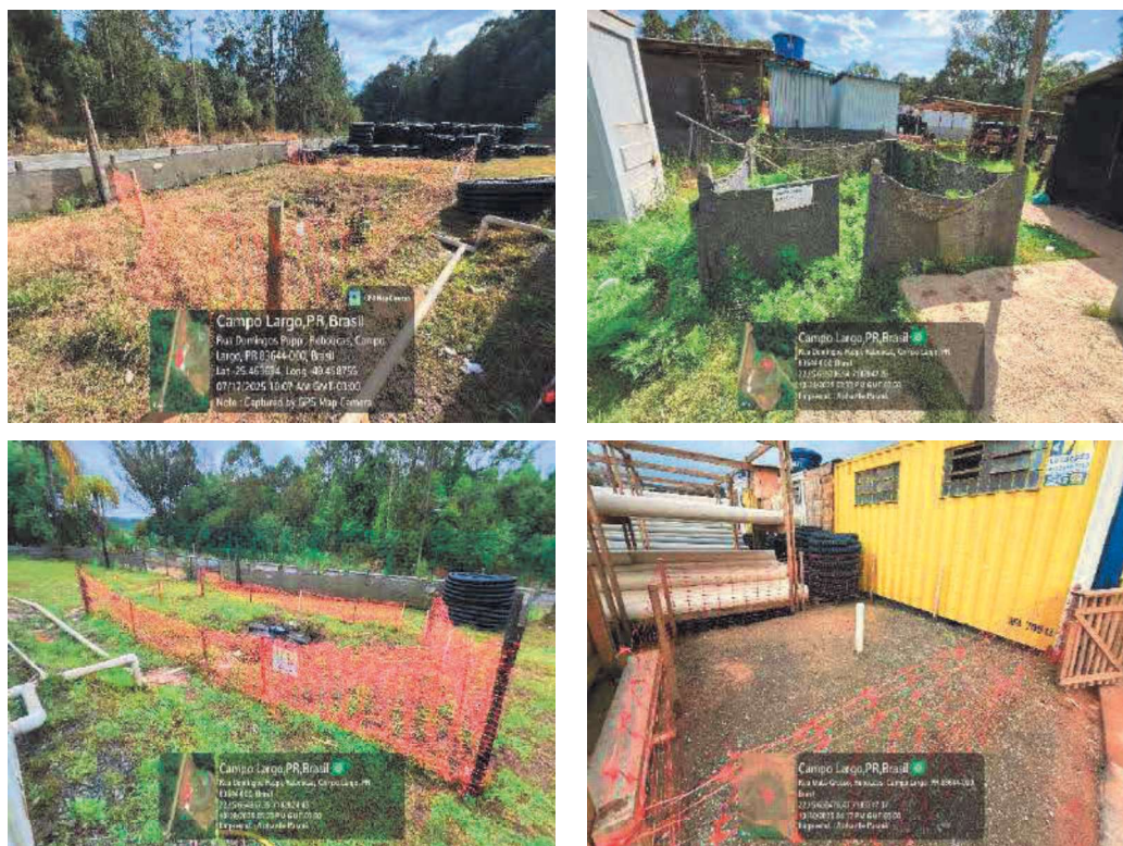
Figura 16 – Tanques impermeáveis para armazenamento do efluente
