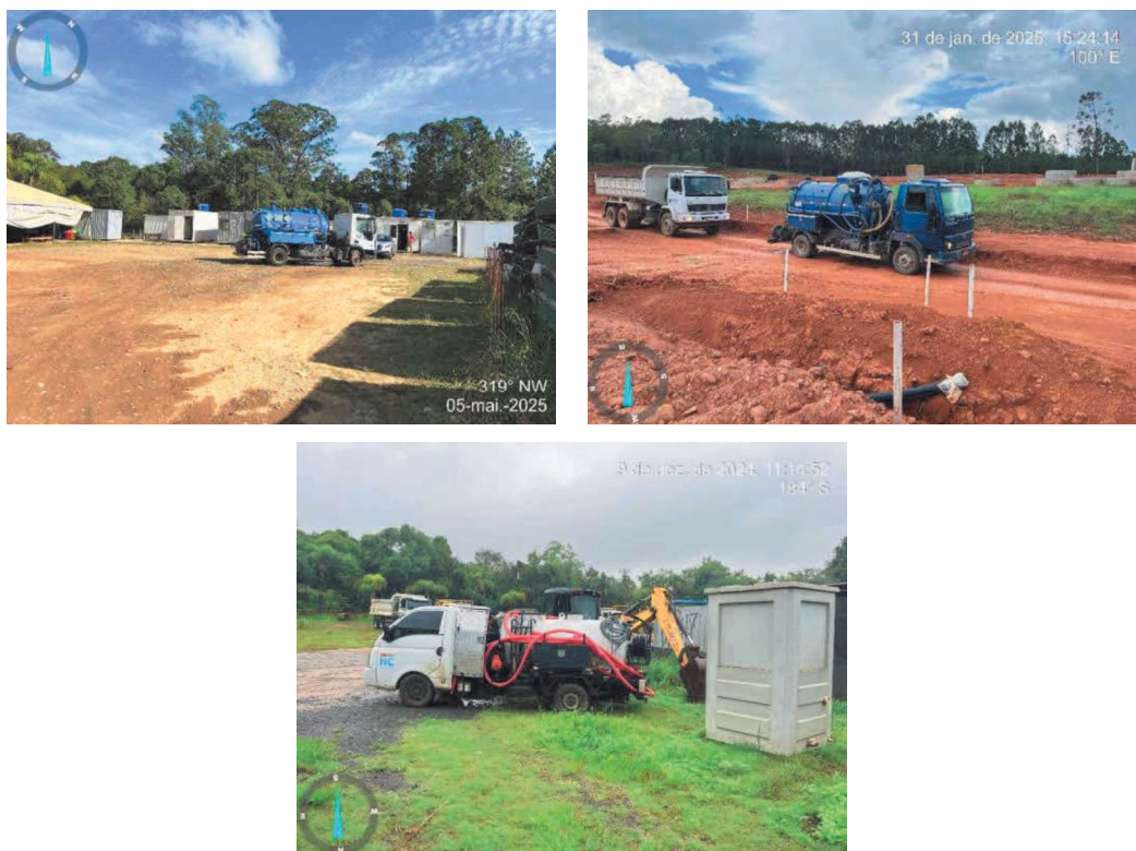
Figura 17 – Tanques impermeáveis para armazenamento do efluente
