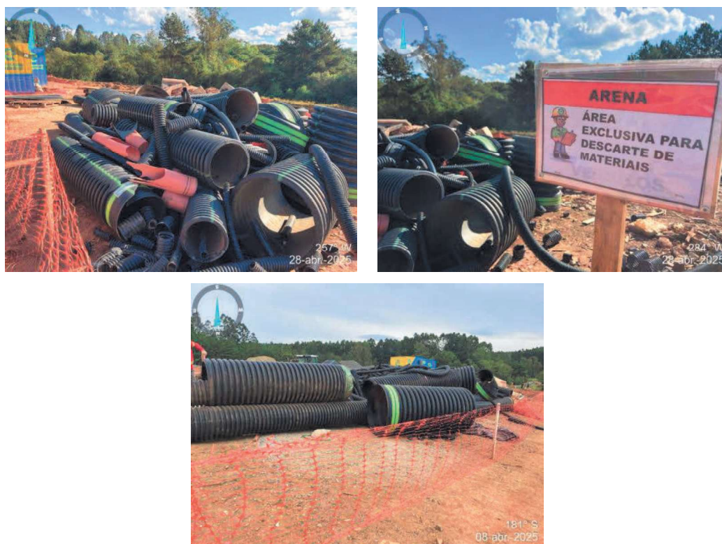
Figura 6 – Armazenamento de tubos plásticos que não serão utilizados aguardando descarte
