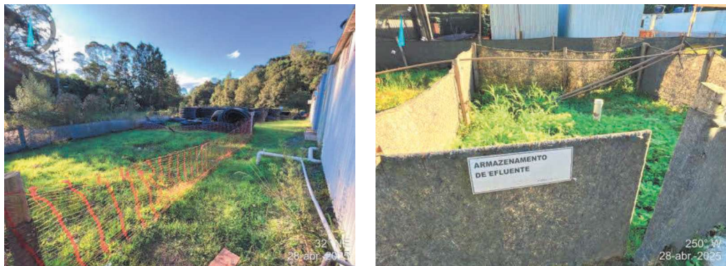
Figura 16 – Tanques impermeáveis para armazenamento do efluente
