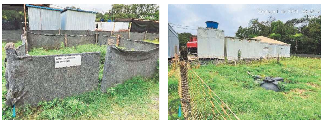
Figura 11 – Tanques impermeáveis para armazenamento do efluente
