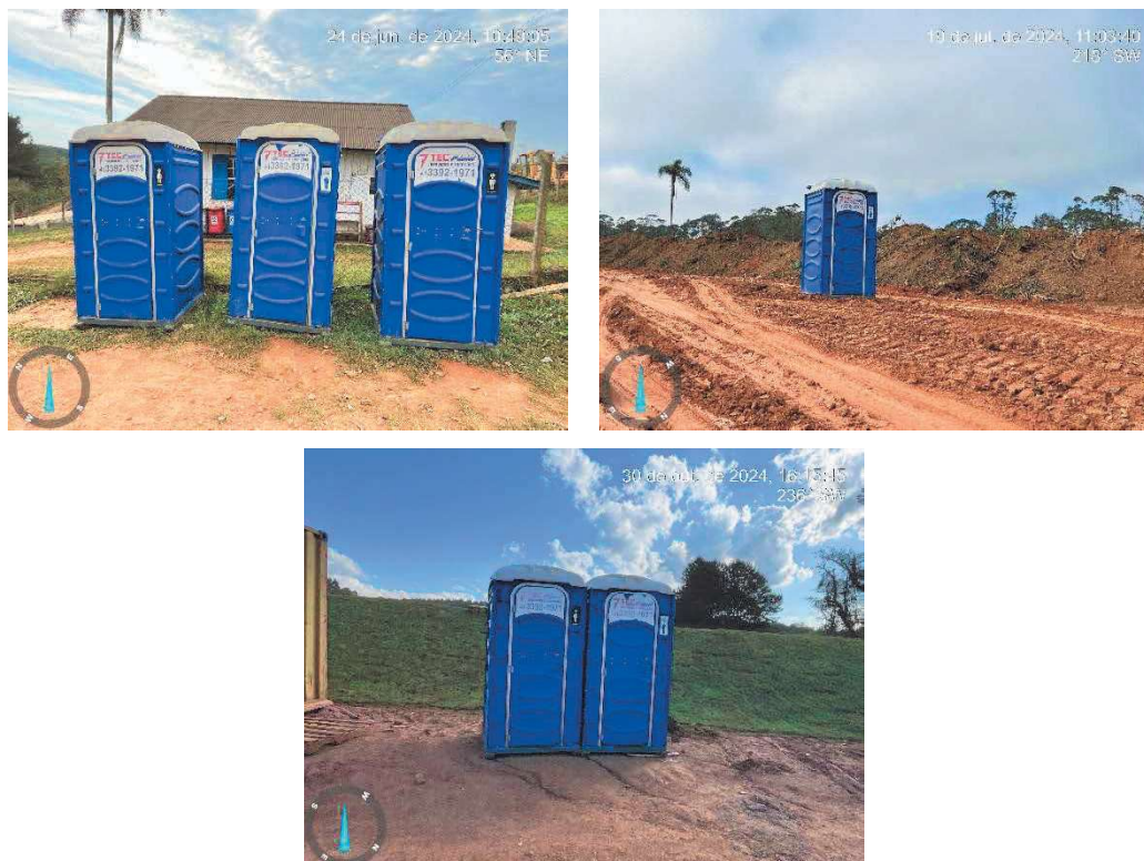
Figura 10 – Banheiros químicos disponíveis aos colaboradores
