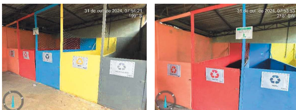
Figura 8 – Baia para armazenamento resíduo Classe D
