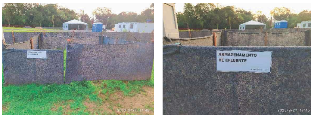
Figura 15 – Tanque de armazenamento do efluente do escritório
