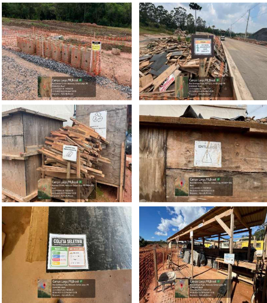
Figura 26 – Sinalizações orientando a gestão dos resíduos, limpeza e organização
