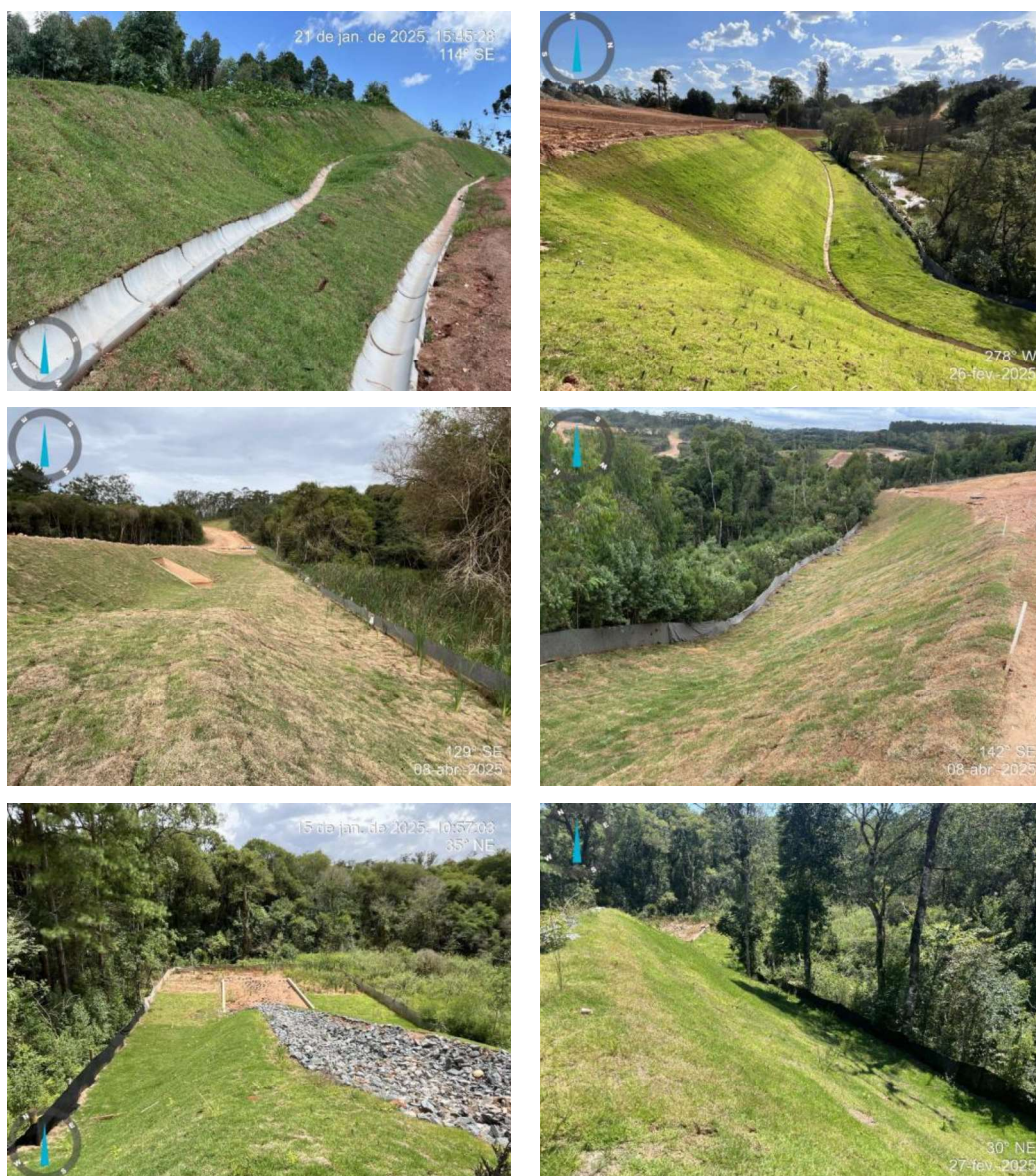
Figura 6 – Paisagismo de proteção e enrocamentos no dissipadores
