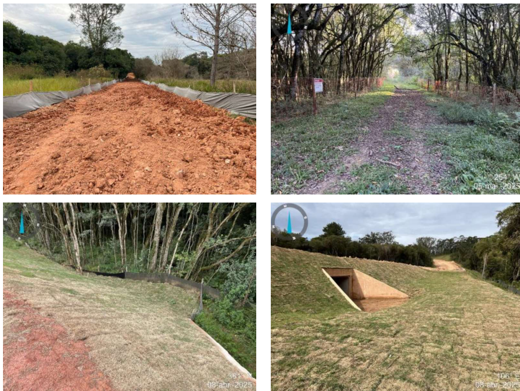
Figura 3 – Intervenções em APP devidamente autorizadas pelo órgão ambiental
