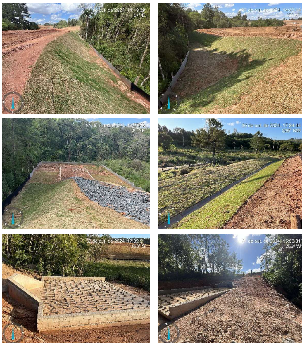
Figura 9 – Paisagismo de proteção e enrocamentos no dissipadores
