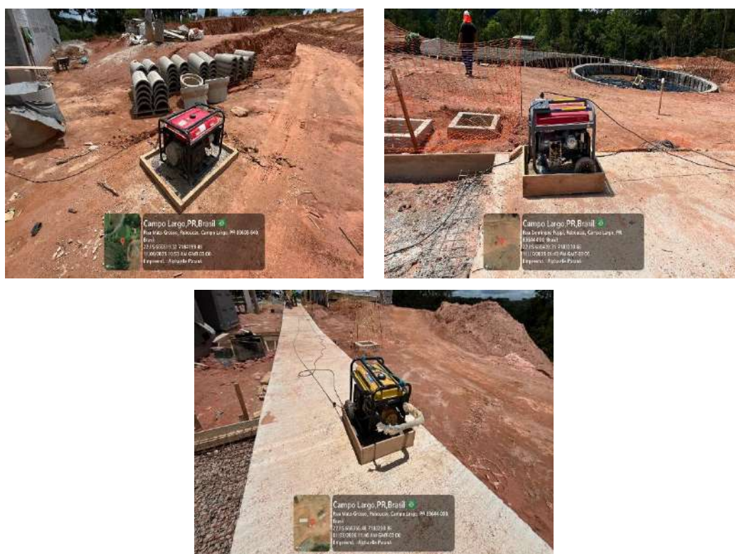
Figura 23 – Proteções provisórias para geradores móveis de energia elétrica
