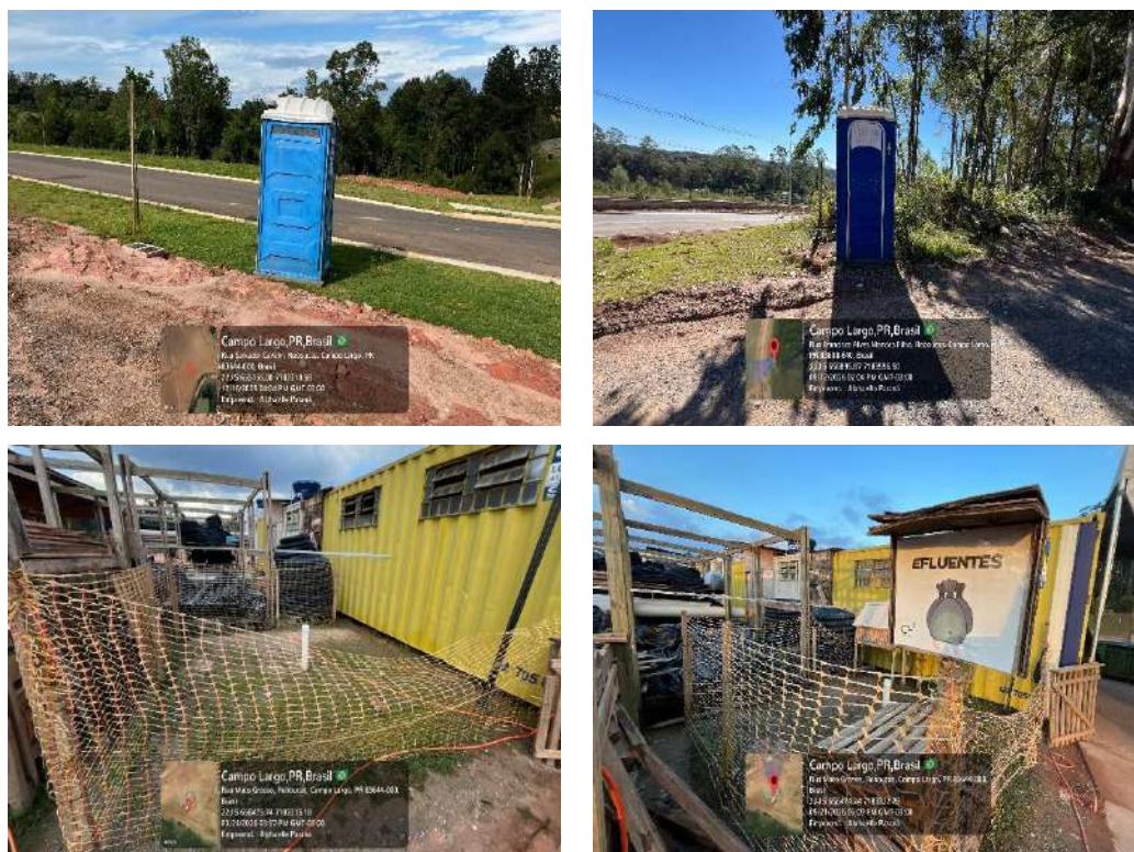
Figura 13 – Banheiros químicos e tanques impermeáveis para armazenar o efluente
