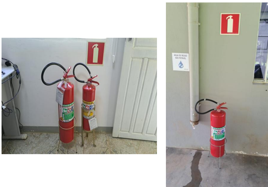
Figura 9 – Extintores de incêndios
