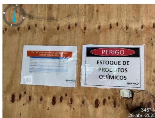
Figura 10 – Sinalizações das áreas de armazenamento de produtos químicos
