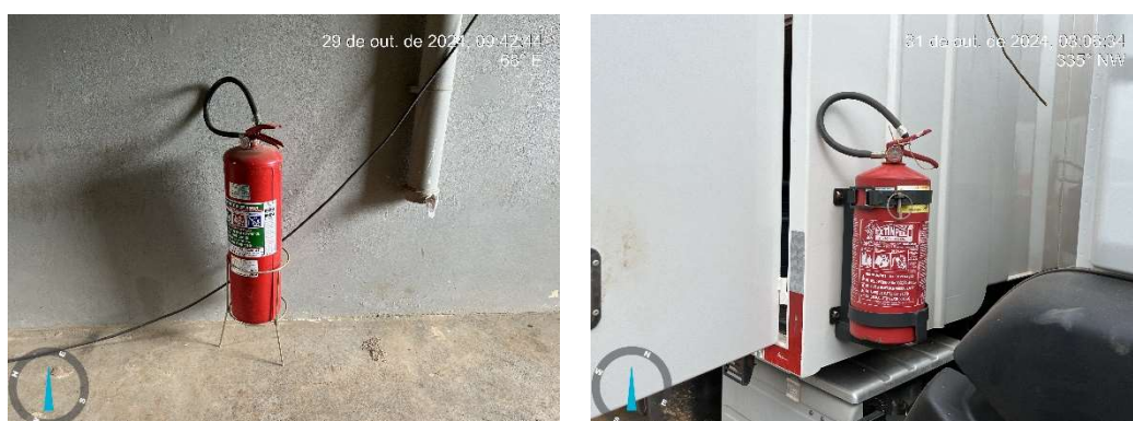
Figura 9 – Disponibilização de extintores de incêndios
