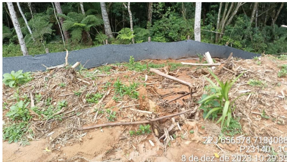
Figura 20. Ponto P08: focos de erosão no entorno do ponto P08.
