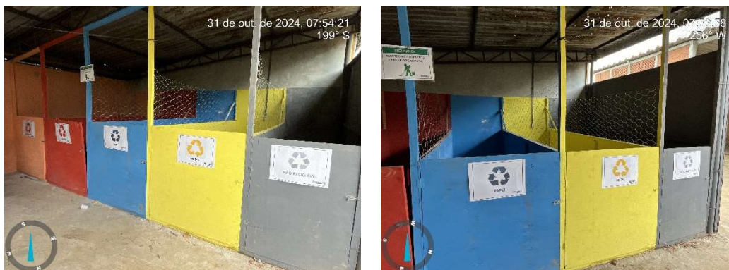
Figura 6 – Baias para armazenamento de resíduos
