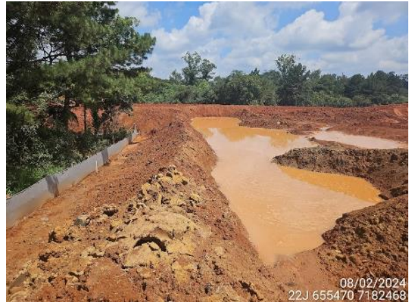
Figura 13. Bacia de contenção com boa função, evitando o carreamento de sedimentos para a APP, à esquerda, delimitada pela manta geotêxtil.
