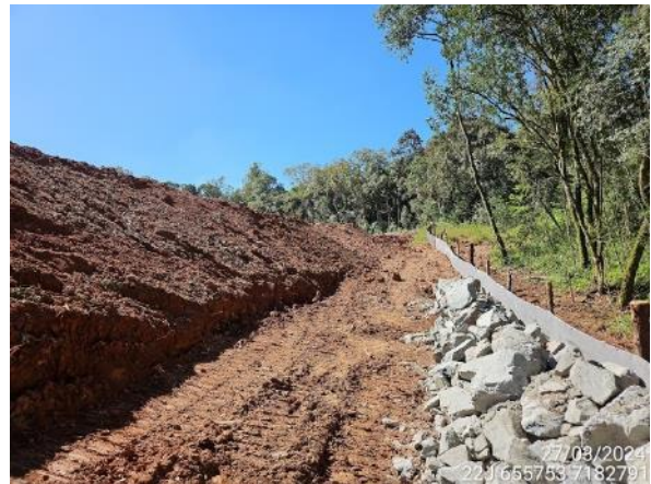
Figura 7. Reconformação de taludes e adição de camada geotécnica a fim de reduzir erosão superficial.
