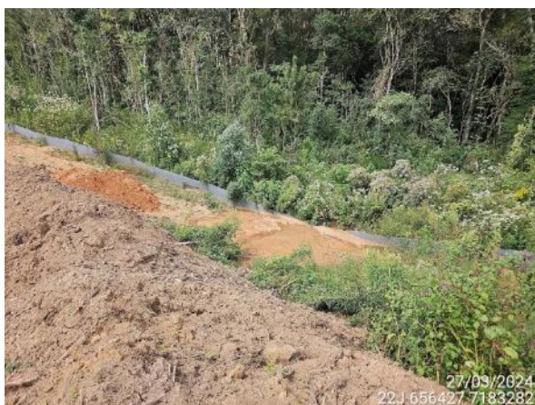
Figura 29. Necessidade de reconfiguração da manta geotêxtil, por sobrecarga de sedimentos, vistoria de 27/03/2024.
