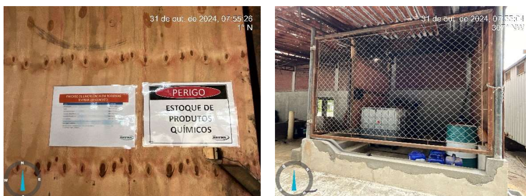
Figura 10 – Armazenamento de produtos químicos
