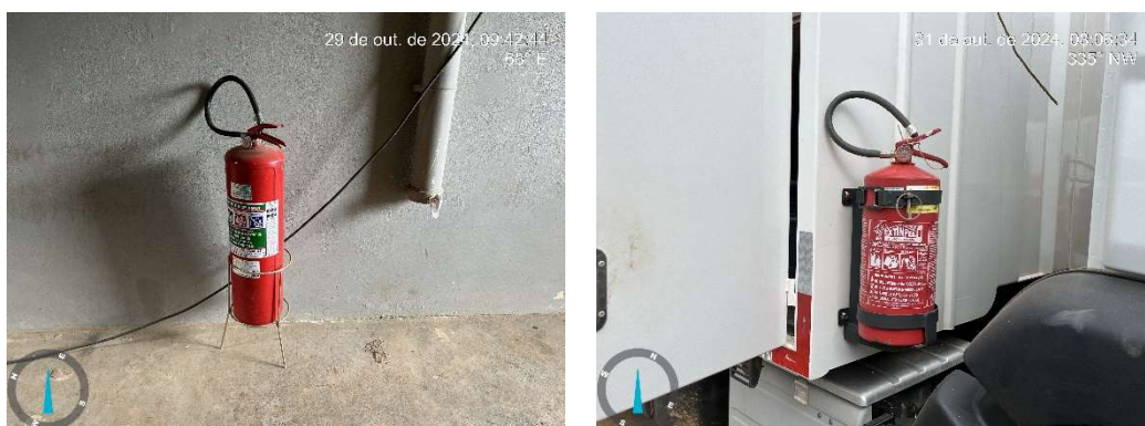
Figura 9 – Disponibilização de extintores de incêndios
