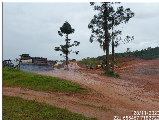
FIGURA 2: OBRA PARALISADA DEVIDO AS CHUVAS NA REGIÃO.
