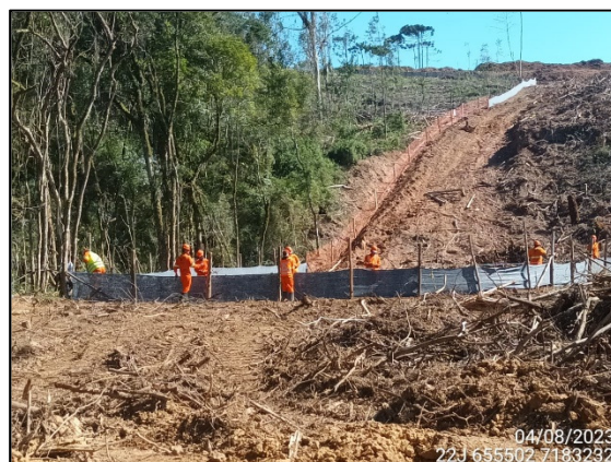
FIGURA 58: CERCAMENTO EM ÁREA DE PRESERVAÇÃO PERMANENTE.
