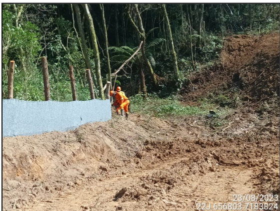
FIGURA 3: CERCAMENTO EM ÁREA DE PRESERVAÇÃO PERMANENTE.
