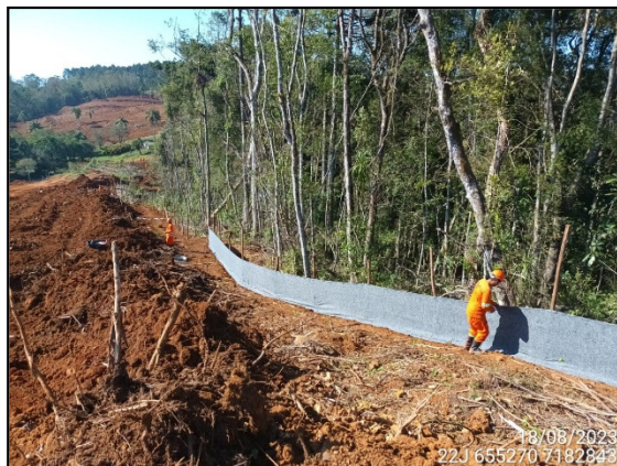
FIGURA 68: CERCAMENTO EM ÁREA DE PRESERVAÇÃO PERMANENTE.
