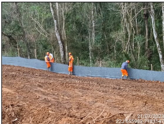
FIGURA 18: CERCAMENTO EM ÁREA DE PRESERVAÇÃO PERMANENTE.
