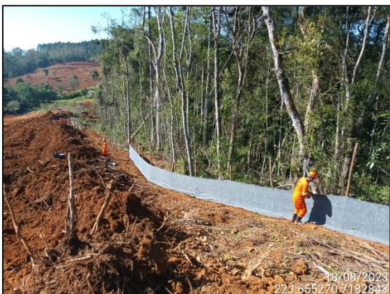
FIGURA 5: CERCAMENTO EM ÁREA DE PRESERVAÇÃO PERMANENTE.
