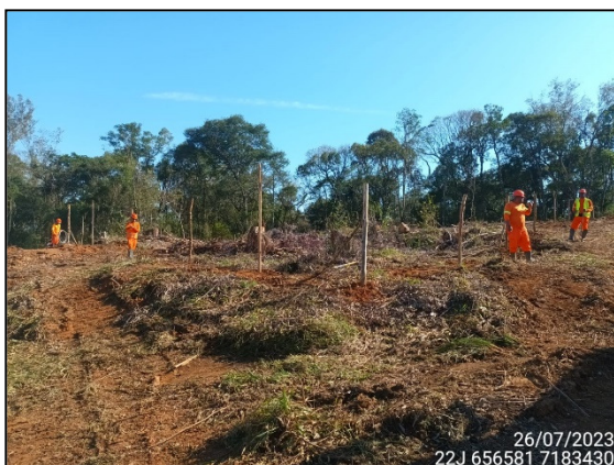
FIGURA 22: CERCAMENTO EM ÁREA DE PRESERVAÇÃO PERMANENTE.
