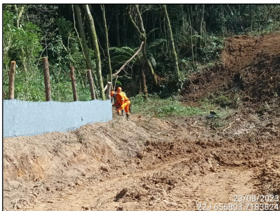
FIGURA 71: CERCAMENTO EM ÁREA DE PRESERVAÇÃO PERMANENTE.
