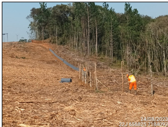
FIGURA 4: CERCAMENTO EM ÁREA DE PRESERVAÇÃO PERMANENTE.
