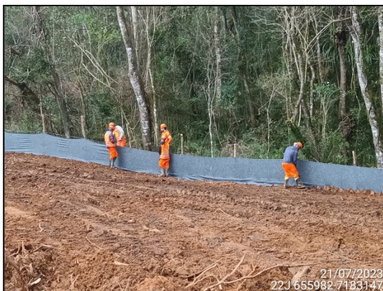
FIGURA 5: CERCAMENTO EM ÁREA DE PRESERVAÇÃO PERMANENTE.
