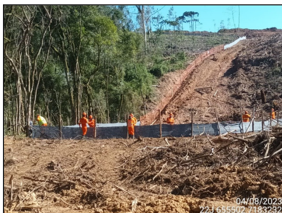
FIGURA 4: CERCAMENTO EM ÁREA DE PRESERVAÇÃO PERMANENTE.
