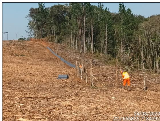
FIGURA 72: CERCAMENTO EM ÁREA DE PRESERVAÇÃO PERMANENTE.
