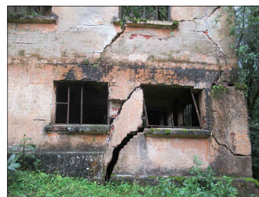
Rachaduras e Ausência de elementos na Fachada Sudoeste Acervo próprio, 2021.
