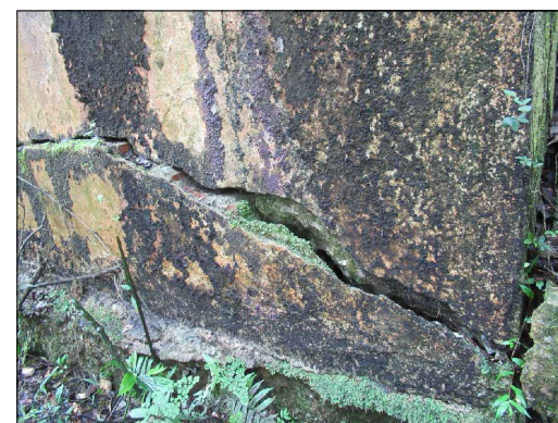
Rachadura, Vegetação e Sujidade na Fachada Nordeste Acervo próprio, 2021.
