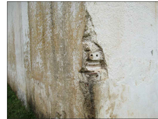
Desprendimento de argamassa na fachada Noroeste. Acervo próprio, 2021.
