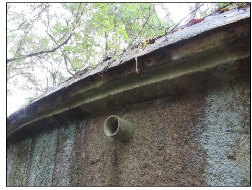
2 Canos nas fachadas Acervo próprio, 2021.
