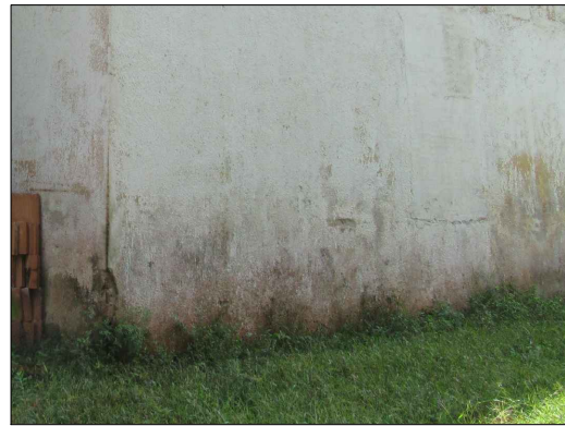
Umidade ascendente e vegetação na fachada Sudeste. Acervo próprio, 2021.
