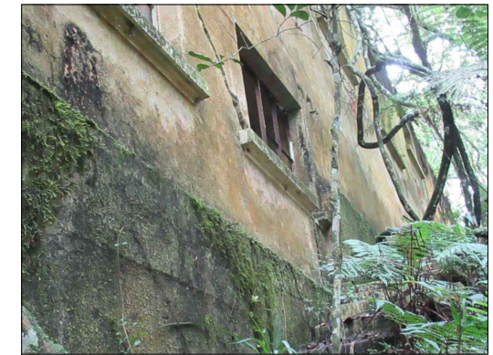
Parede de concreto moldado in loco como base para parede de alvenaria de tijolos Acervo próprio, 2021.
