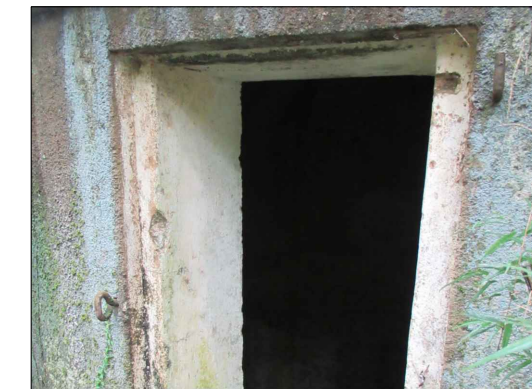
Desprendimento de argamassa e pintura Acervo próprio, 2021.
