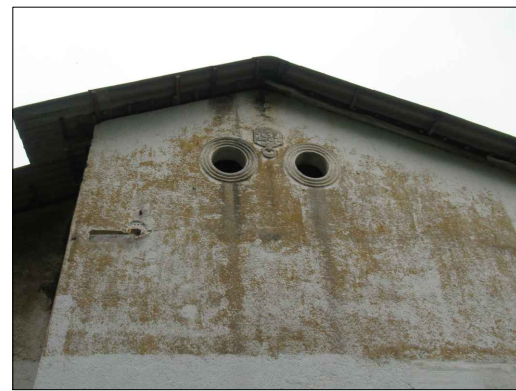
Sujidade na fachada Sudeste. Acervo próprio, 2021.
