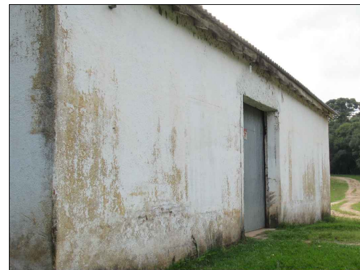
Sujidade na fachada Nordeste. Acervo próprio, 2021.
