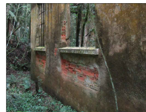
Desprendimento de argamassa e ausência de elementos na Fachada Noroeste Acervo próprio, 2021.
