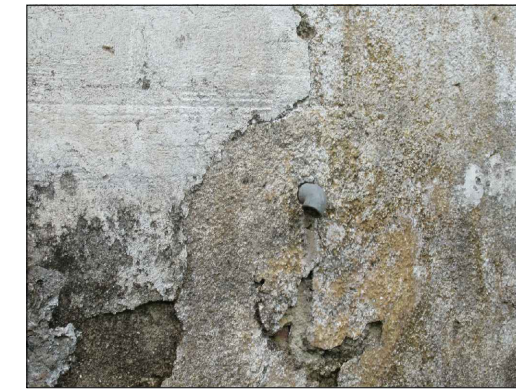
Desprendimento da argamassa na fachada Sudoeste. Acervo próprio, 2021.
