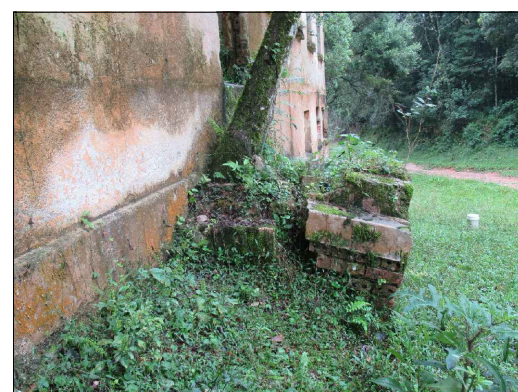
Desmoronamento da escada na Fachada Sudoeste Acervo próprio, 2021.
