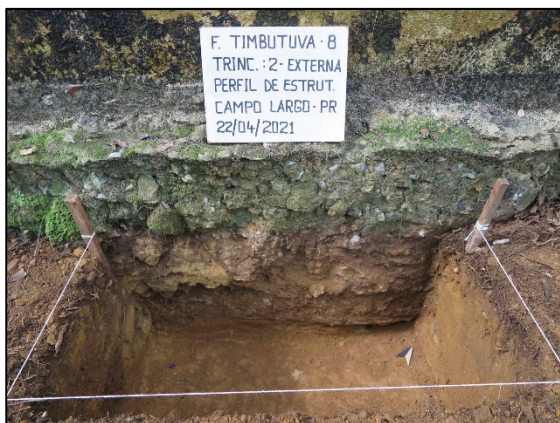
FIGURA 16: TRINCHEIRA 2 NA ÁREA EXTERNA DA EDIFICAÇÃO COM EVIDENCIAÇÃO DO BALDRAME. FONTE: ESPAÇO ARQUEOLOGIA, 2021.
