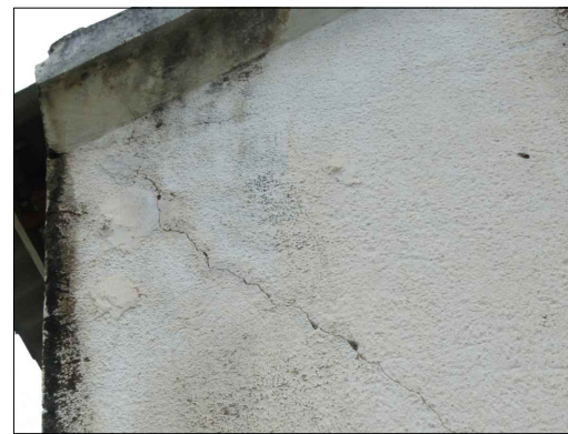
Fissura na fachada Noroeste. Acervo próprio, 2021.
