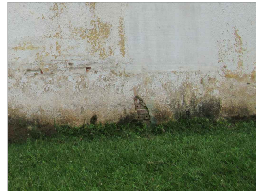
Desprendimento da argamassa na fachada Nordeste. Acervo próprio, 2021.
