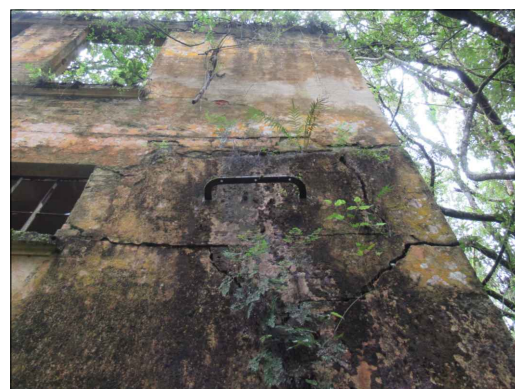
Rachaduras, Vegetação e Sujidade na Fachada Nordeste Acervo próprio, 2021.
