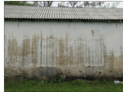
Sujidade e desprendimento da pintura na fachada Sudoeste. Acervo próprio, 2021.
