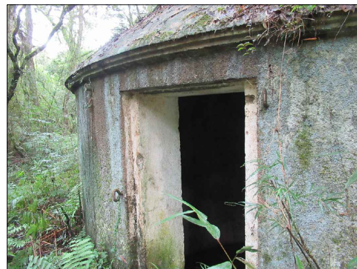
Ausência de elemento (porta) Acervo próprio, 2021.
