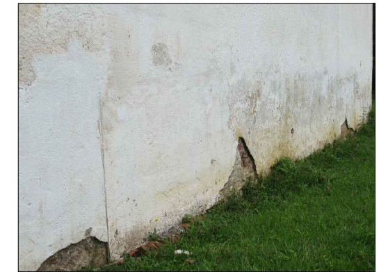
Desprendimento da argamassa na fachada Noroeste. Acervo próprio, 2021.
