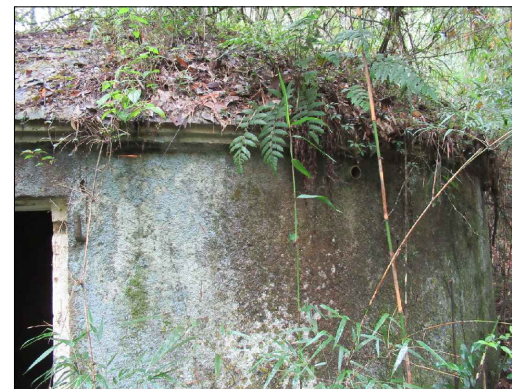
Vegetação e Sujidades na cobertura e nas paredes Acervo próprio, 2021.
