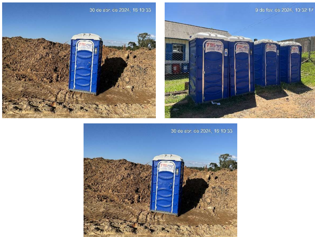
Figura 6 – Banheiros químicos disponíveis aos colaboradores
