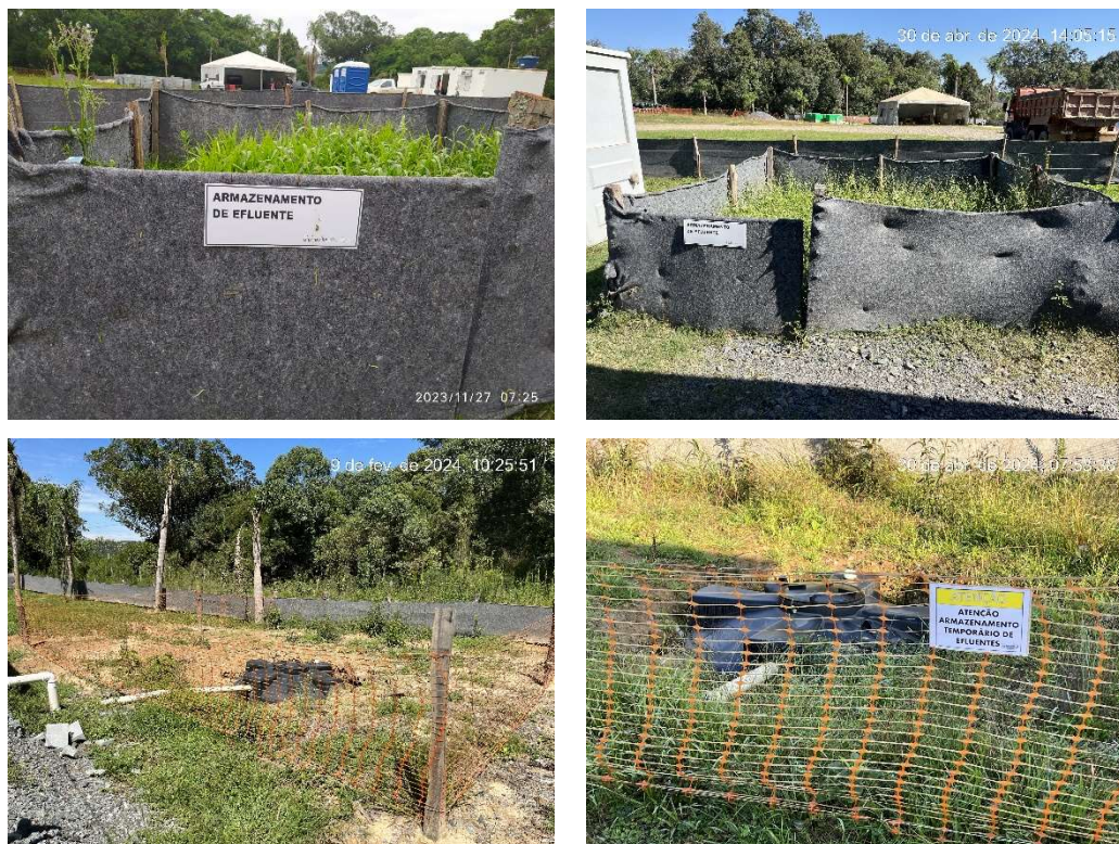
Figura 7 – Tanques impermeáveis para armazenamento do efluente
