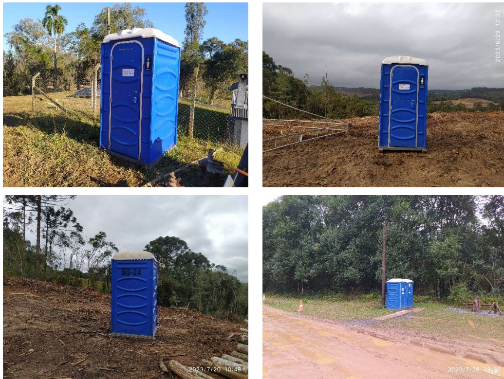
Figura 13 – Banheiros químicos disponíveis aos colaboradores
