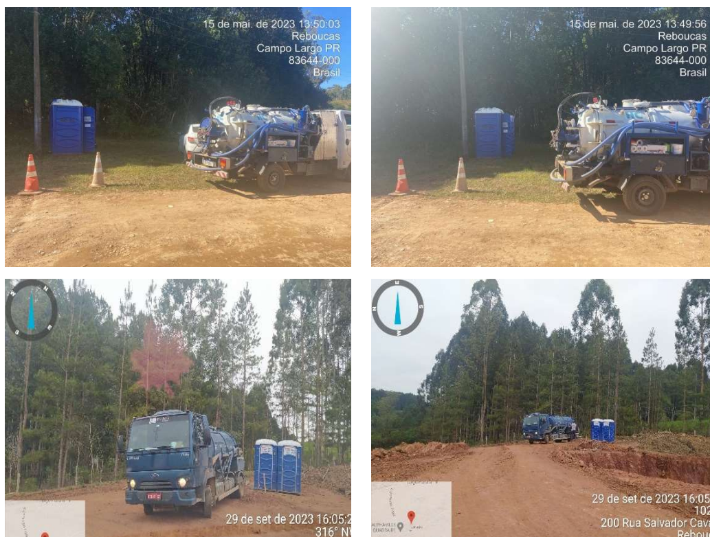
Figura 14 – Manutenção e recolhimento do efluente junto aos banheiros químicos
