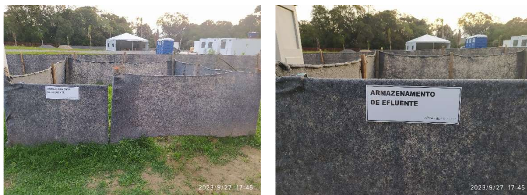
Figura 15 – Tanque de armazenamento do efluente do escritório
